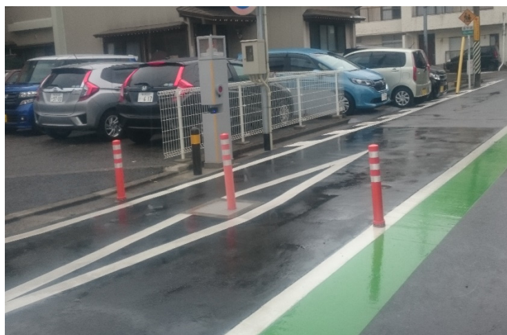
図 2-9 ソフトライジングボラードと制御ボックス（左側灰色のボックス）
