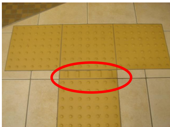
6-1 このケースのように、警告ブロックに挟まれた長さが5cm程度の誘導ブロックでは、視覚障害者はそれに気づかない。したがって無駄な設置と言わざるを得ない。（東京・新橋）
