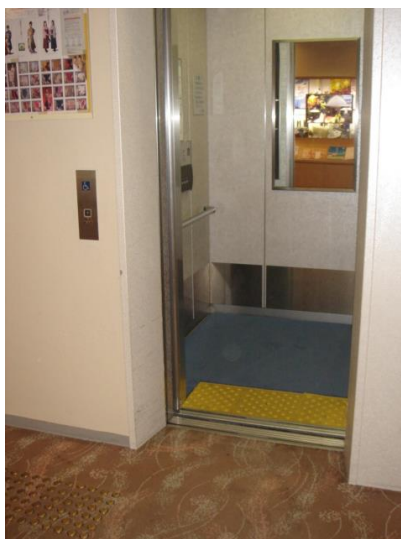
15-2 エレベータ内に警告ブロックを設置しているケースがある。狭いエレベータ内で出口を迷う視覚障害者はいない。このような設置も車いす使用者等のバリアになるため、ブロックを撤去すべきである。（愛媛県松山市）
