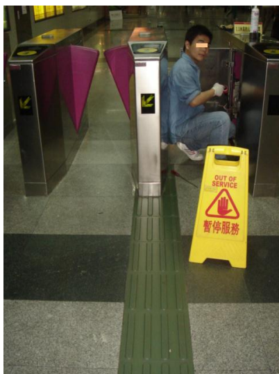
21-9 ブロック上に地下鉄の自動改札機が設置されている。（中国・広州）
