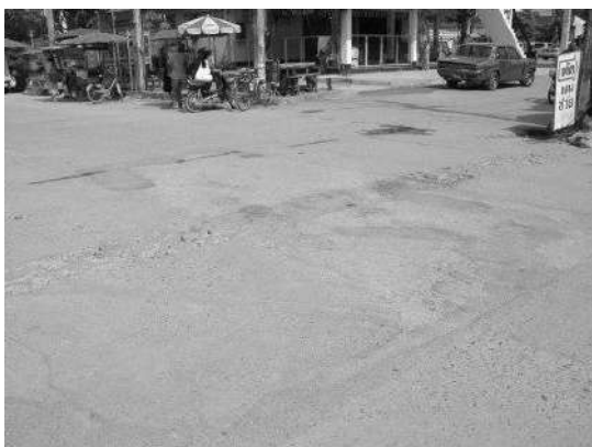
写真2-11 道路の舗装状態は決して良くない
