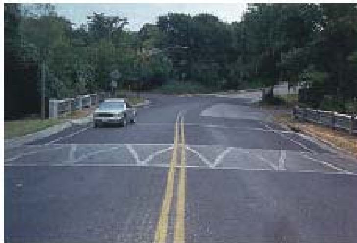
写真 5-8 スピードテーブル
