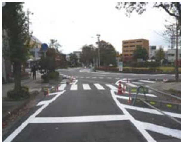
写真-2.1 S流出部付近の境界ブロック
