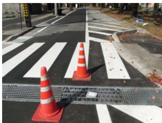
④発光鋏設置位置の外観
