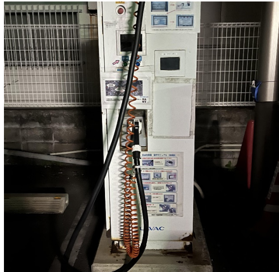
市内中心部の駐車場に設置された急速充電器
