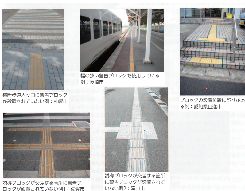
図3 不適切な警告ブロックの設置例
