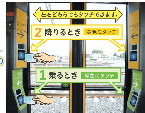
▲車両の全扉の両側に設置されたICカードリーダー
