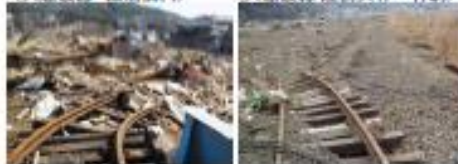
G【線路流失】 (気仙沼線 大谷海岸橋内) H【横けた流失】 (気仙沼線 陸前小泉～本吉) I【線路流失】 (石巻線 女川橋内)
