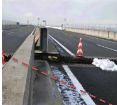
(2) 仙台東部道路・仙台港北IC～仙台東IC間 橋梁ジョイント損傷状況 (3月12日撮影) 橋梁の継ぎ目部分が斜めにずれ段差が発生。
