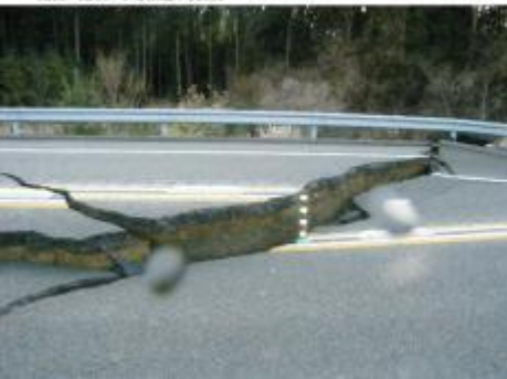
(4) 常磐自動車道 広野IC～常磐宮岡IC 土工部損傷状況 (3月12日撮影) 路面に陥没による段差が発生。
