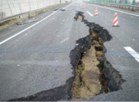
(3) 東北自動車道 福島坂元IC～国見IC 土工部損傷状況 (3月12日撮影) 路面に亀裂と剥打ちが発生。
